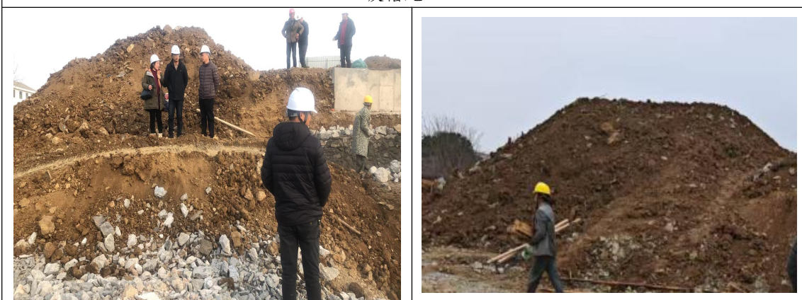
临时堆土需完善苫盖及拦挡措施
