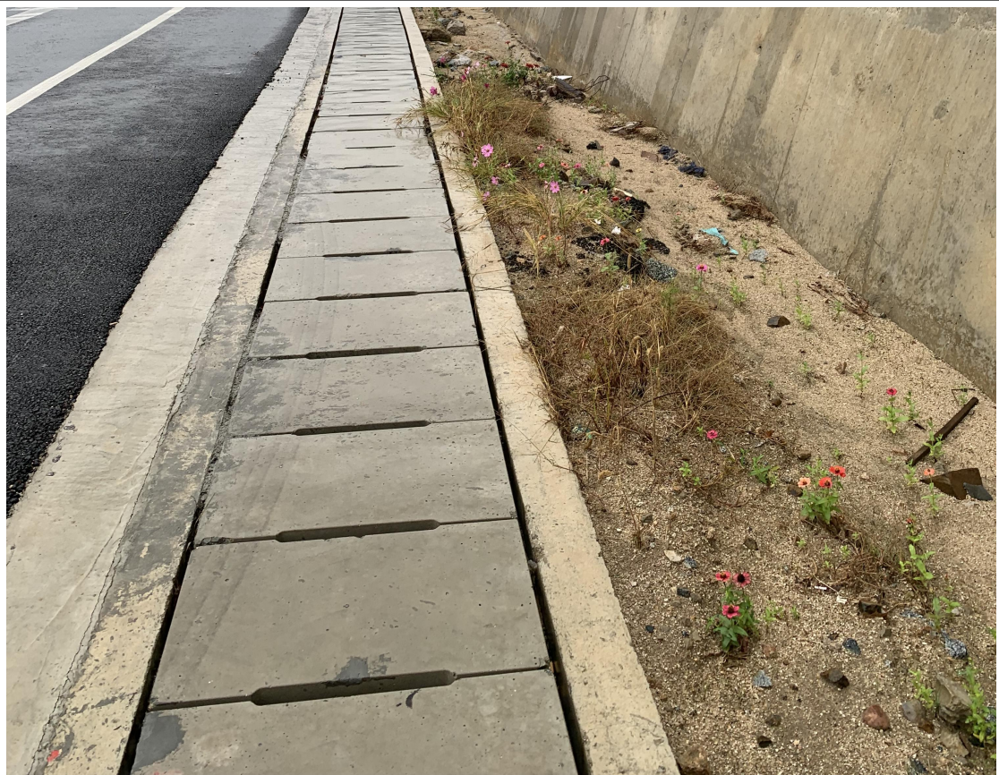
L 主线排水沟
