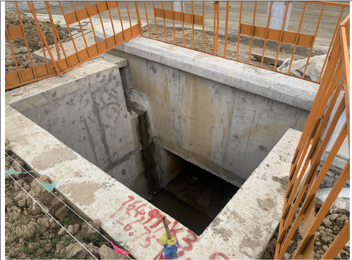
雨水井兼顾沉淀泥沙功能
