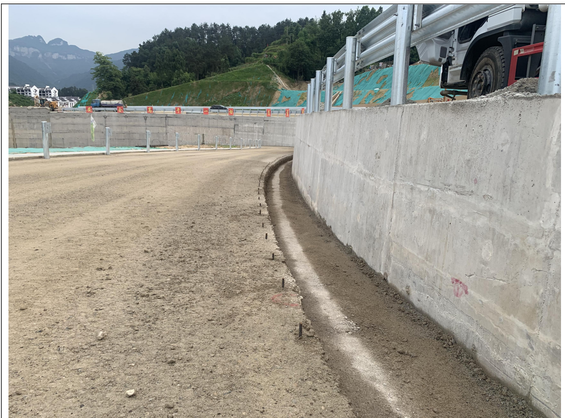
PA辅路排水沟
