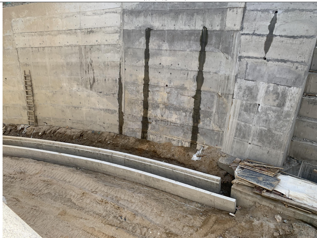
PA辅路排水沟
